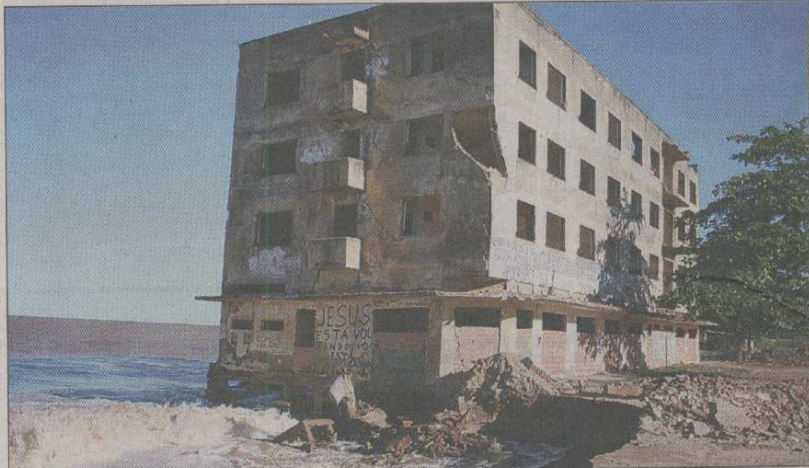
O PRÉDIO em Atafona, São João da Barra: ele deverá ser demolido antes que a força das águas o derrube
